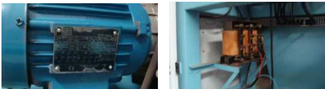
Foto 7 – Motor elétrico e transformador
