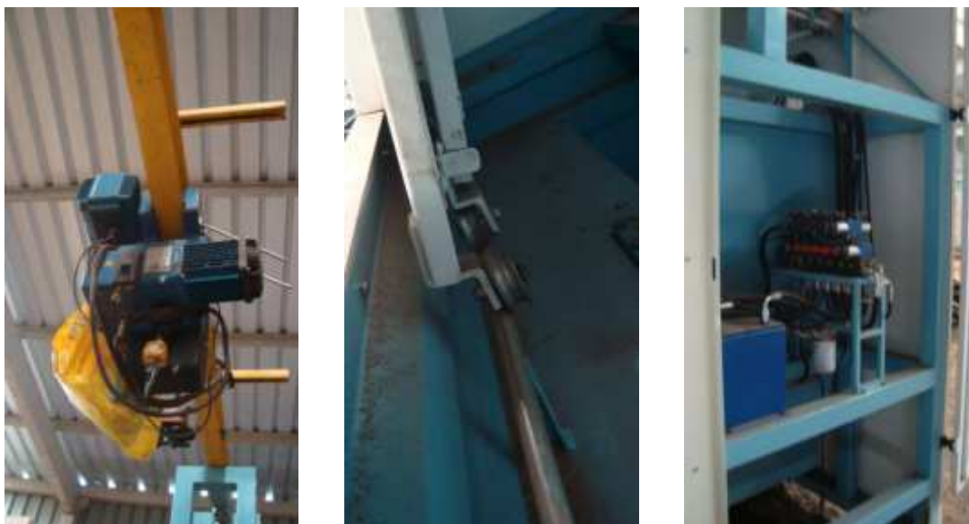
Foto 4 – Pórtico com talha elétrica para içamento do material que será retificado Sistema de translação da porta frontal e Sistema de controle hidráulico
